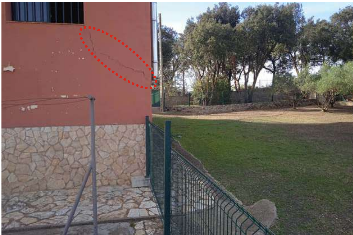
Xamfrà nord-est de l'habitatge de Sant Gregori amb indicació d'una fissura.
