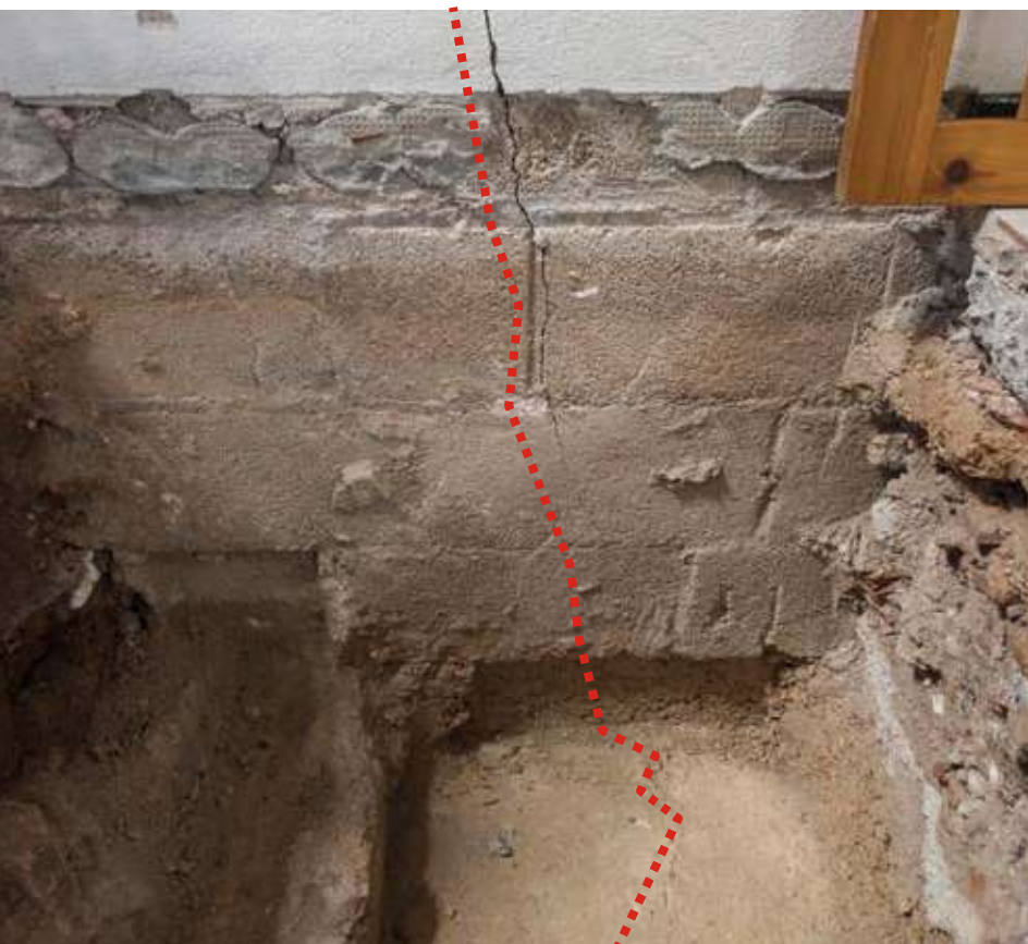
Cala de fonamentació amb presència d'una esclatxa que afecta el mur de soterrani i la sabata.
