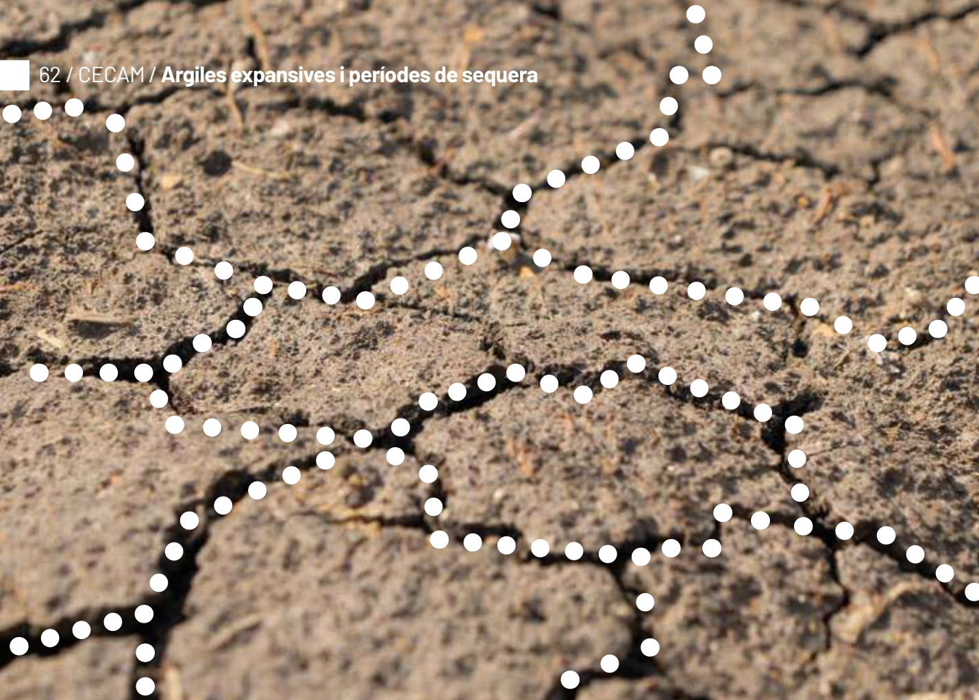
Imatge en primer pla d'un terra sec argilós amb gerres visibles i fissures pronunciades, resultat de l'evaporació de l'aigua i la compactació de l'argila. Imatge extreta d'un banc d'imatges.
